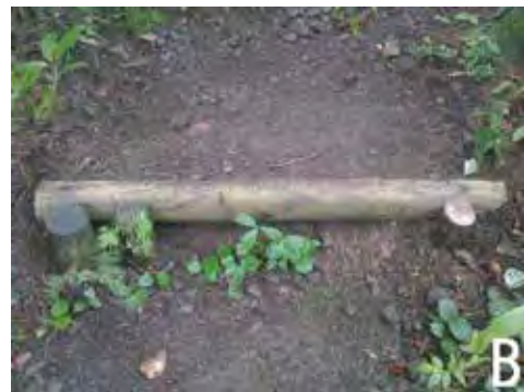
図3 観察路施設の補修例。A：交換前。B：交換後。モミ・コナラ・イワガラミ(稚樹)が、蹴込み付近の表面侵食を抑えていると考え(蹴込み付近の路面が洗掘を受けやすい)、これらをできるかぎり保護して腐朽部材のみを交換した。
