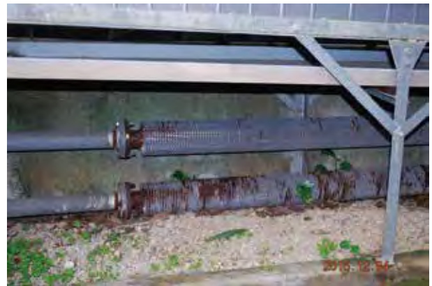
図6 ギルドの腐食.
