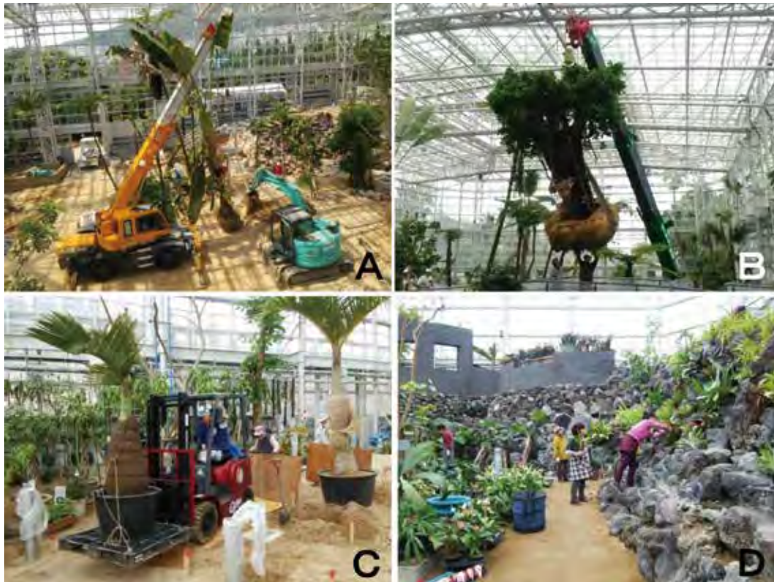
図15 展示植物植栽工事・配置作業。A：タビビトノキの移植作業。B：ガジュマルの移植作業。C：コンテナ植えのヤシの移動。D：ボランティアによる鉢植え植物の展示飾り付け作業。
