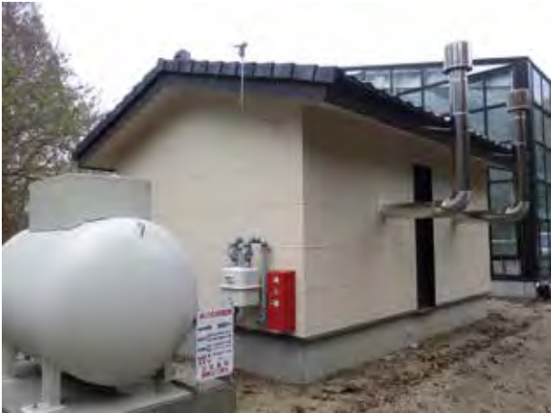
図16 新しいボイラー室。
