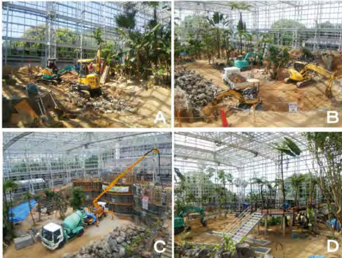
図13 展示施設基盤等整備工事。A：既存の池や通路等の取り壊し。B：既存の溶岩壁やトンネルの取り壊しと溶岩の再利用のための積置き。C：熱帯古城の溶岩壁造成工事。D：スロープデッキ通路の組み立て工事。
