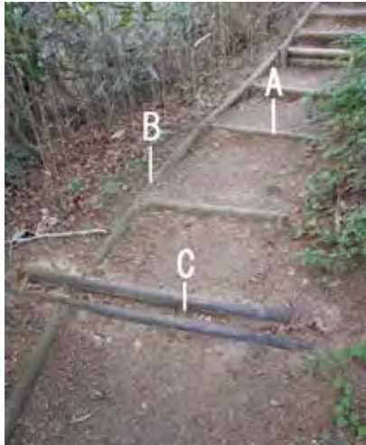
図2 観察路を構成する主な施設。A：階段。B：路肩丸太。C：排水溝。階段は傾斜地に、路肩丸太は主に観察路の谷側の路肩に設置されている。降雨時に表面流や滞水が頻出するところでは排水溝を設けている。
